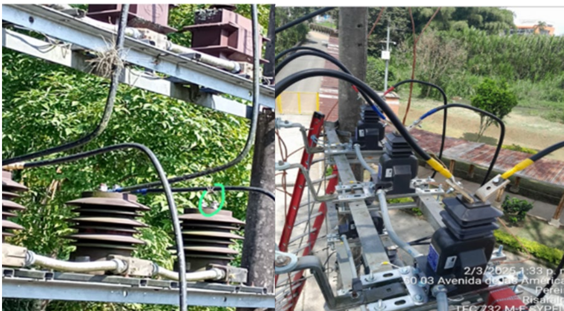
Imagen 132. Mantenimiento a transformador
